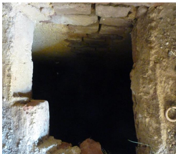
Srušeni dio podnice zvonika
